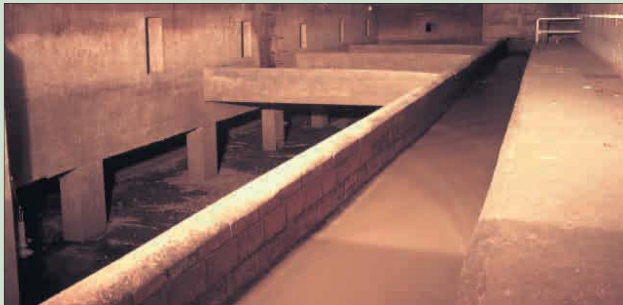
25 Meter lang ist das Sammelbecken unter dem Komturplatz. Wenn der Abwasserkanal (rechts) überläuft, können hier bis zu 1200 Kubikmeter Abwasser „zwischenlagert“ werden. (Foto: R. Buhl)
