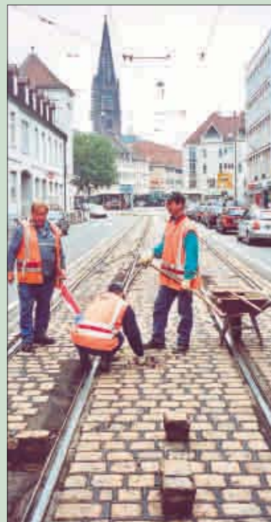
Flickschusterei: Der Sanierungsbedarf ist schon seit Jahren augenfällig.
