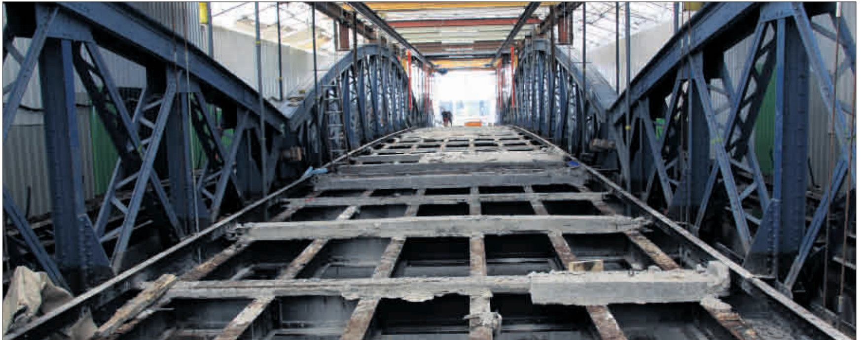
Licht erst am Ende der Brücke: Wie hoch der Sanierungsaufwand tatsächlich ist, stellt sich erst nach und nach heraus. Abwarten heißt es auch für Fußgänger und Radfahrer: Frühestens im Juli führt hier der Weg wieder in den Stühlinger.
