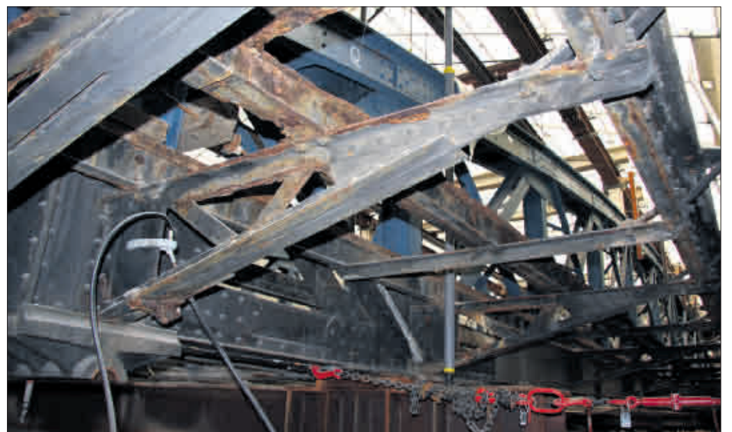
Bodenlos: Nach der Anhebung der Brücke und dem Abriss der Fahrbahn zeigen sich die Schäden an den Stahlträgern im Unterbau. (Alle Fotos: GuT)
