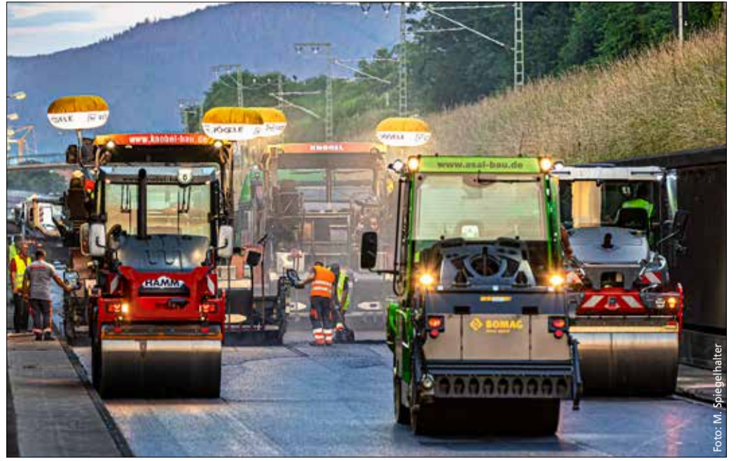
Streetart: Innerhalb von 80 Stunden bekam die B31 an Pfingsten einen neuen Fahrbahnbelag. Es war nicht die größte Baustelle des Jahres, aber sicher die am besten choreografierte.
