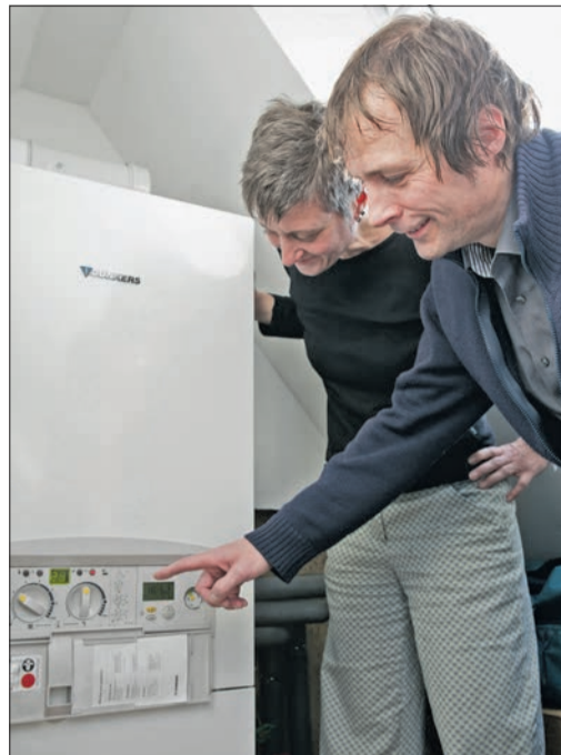
Gute Einstellung: Heizung und Warmwasser brauchen viel Energie. Wer sein Heizgerät optimal einstellt, kann CO 2 und Euros sparen, erläutert Energieberater Ingo Falk.
